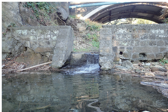
図4 コンクリートの段差
